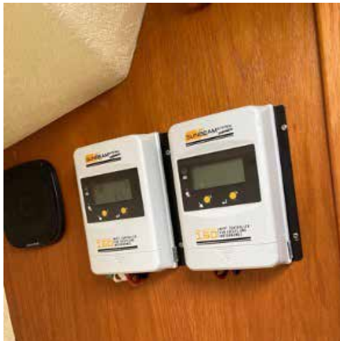
Aurinkopaneelien lataussäätimet asennettuna
